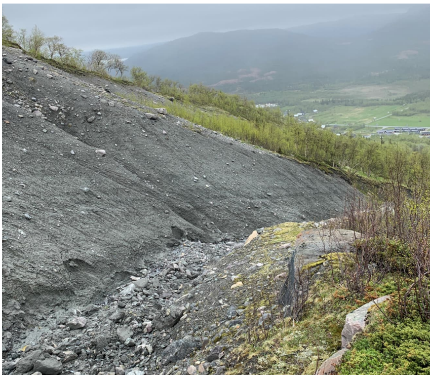
Figur 5. Till vänster syns pågående erosion i den östra slänten och nere till höger i bild syns berg i dagen.
