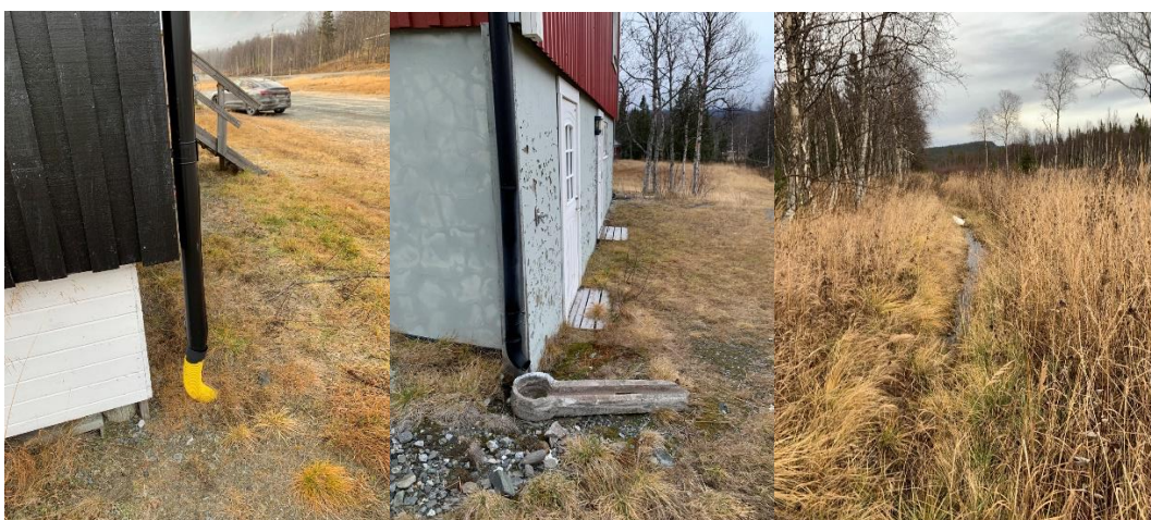
Figur 15 till vänster. Stuprör för infiltration av dagvatten från norra sidan av lägergårdstaket.
