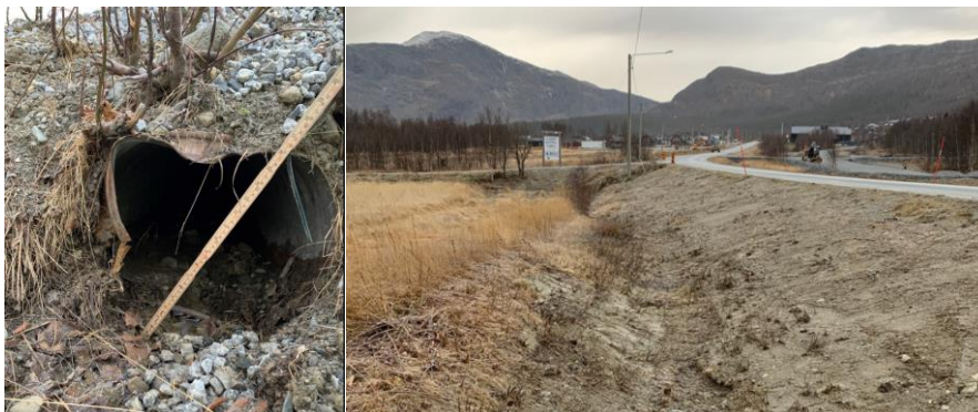
Figur 13 till vänster. D400-trumma (T2) under befintlig infartsväg till lägergård.
