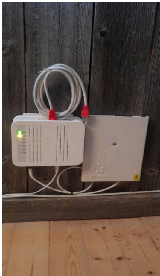
Bild på färdig installation
